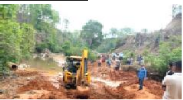
क्याप्सन: कोविडकै बेला मदन भण्डारी लोकमार्गको गाईघाट-कटारी खण्डको मौवासीमा सडक मर्मत गर्दै । तस्विर: मुलुकी
