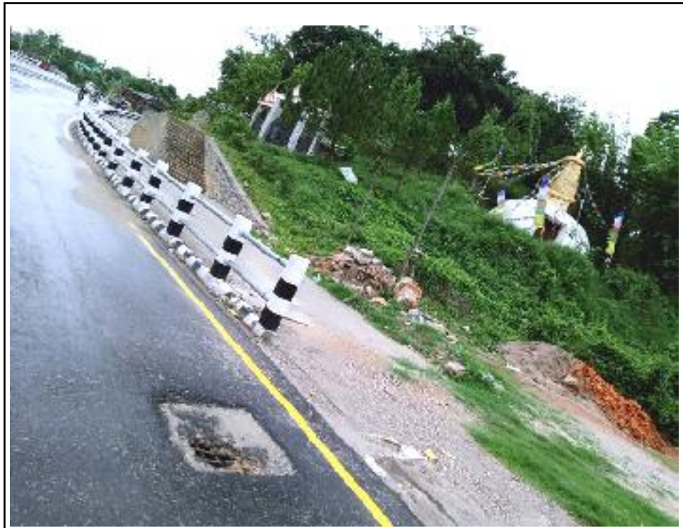
सडकमा खतरा- मदनभण्डारी लेकमार्गको गाईघाटस्थित श्रमिक पार्कमुनी रहेको सडक प्वाल परेको छ। सडकमा प्वाल परेसँगै सवारी साधन लाई खतरा बढेको छ। तस्वीर - मुलुकी
