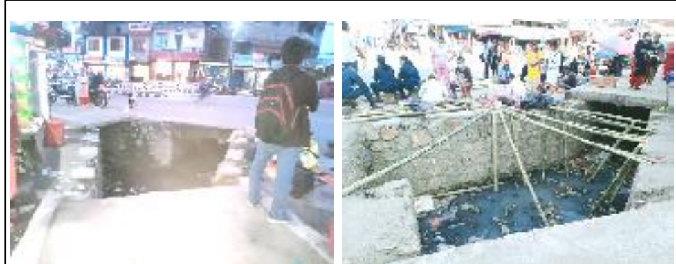
४ दिनको फरक। उदयपुर सदरमुकाम गाईघाटको मुख्यचोकको छेउमा रहेको सडकपेटीको नाली। वैशाख ९ गते विहिवार को पहिलो फोटो बाया र वैशाख १३ गते सोमवारको फोटो दोस्रो दाया। सडकपेटीको नालीको ढकन लगाउने काम गर्नको लागि बास लगाउँदै। तस्विर - तस्विर - मनिता कुमारी राई
